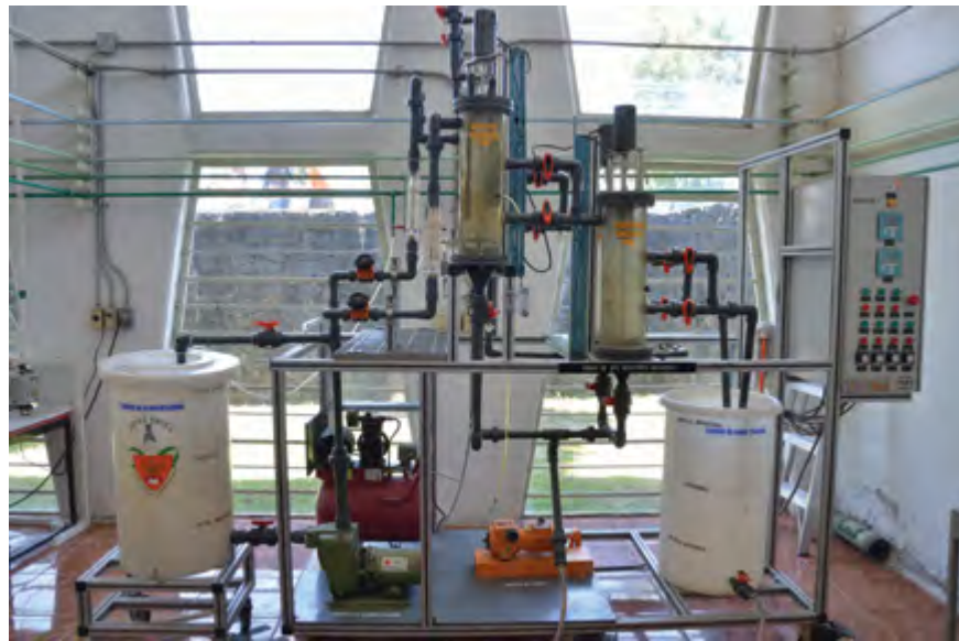
Figura 4.48: Unidad de dos reactores biológicos.
