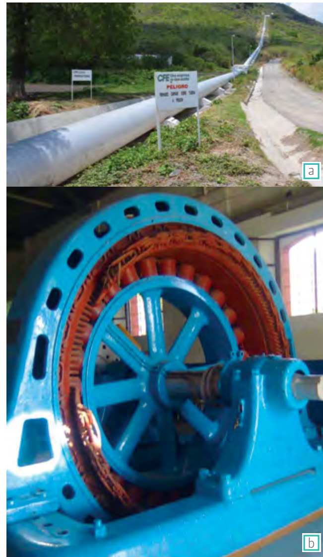
Figura 4.31: (a) Tubería de presión y, (b) un alternador de la central hidroeléctrica de Portezuelo, Atlixco, Puebla.
